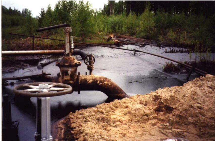
Рис. 2. Последствие канавочной коррозии
