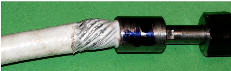
Рис. 4. Разгерметизация трубопровода при повреждении внешнего полимерного слоя в области соединительного элемента
