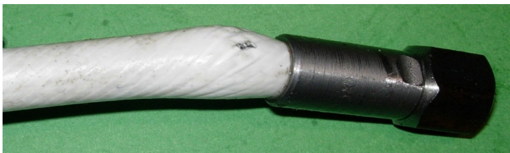
Рис. 3. Область разгерметизации трубопровода
