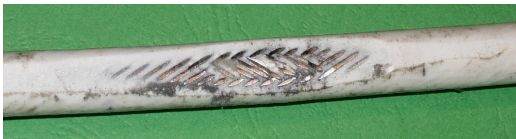
Рис. 5. Разгерметизация трубопровода в области повреждение внешнего полимерного слоя и двух проволочных оплеток
