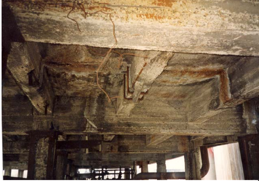
Фото 1. Разрушения конструкций перекрытий
