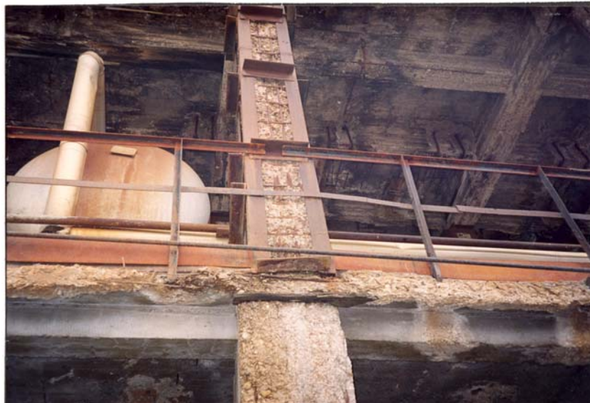
Фото 2. Разрушения конструкций перекрытий и колонн
