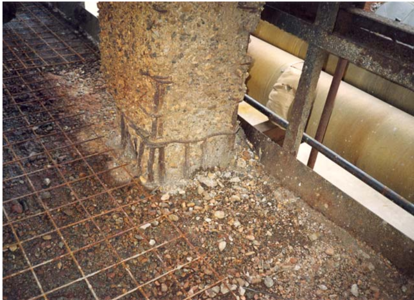
Фото 3. Разрушение стыков колонн
