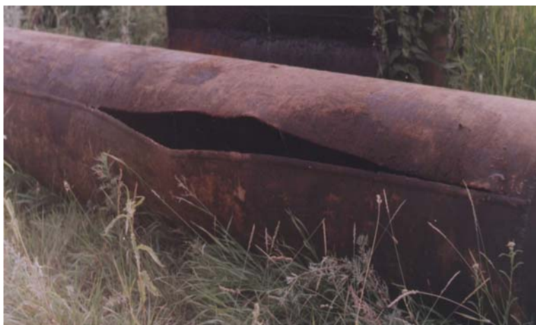
Рисунок 1 - Вид разрушения прямошовной электросварной трубы
